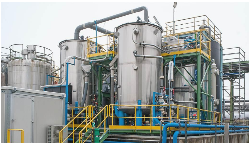
Vue de la ligne de traitement SOFHYS sur site
